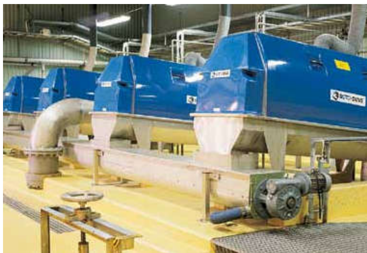
Installation de tamis rotatifs Roto-Sieve modèle RS 51 dans la station d'épuration Kullavik à Kungsbacka (Suède).
