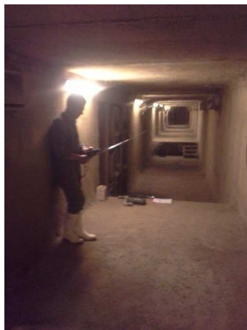
Photo 4 : Mesure de la vitesse d'air dans la gaine de ventilation à l'aide d'un anémomètre
